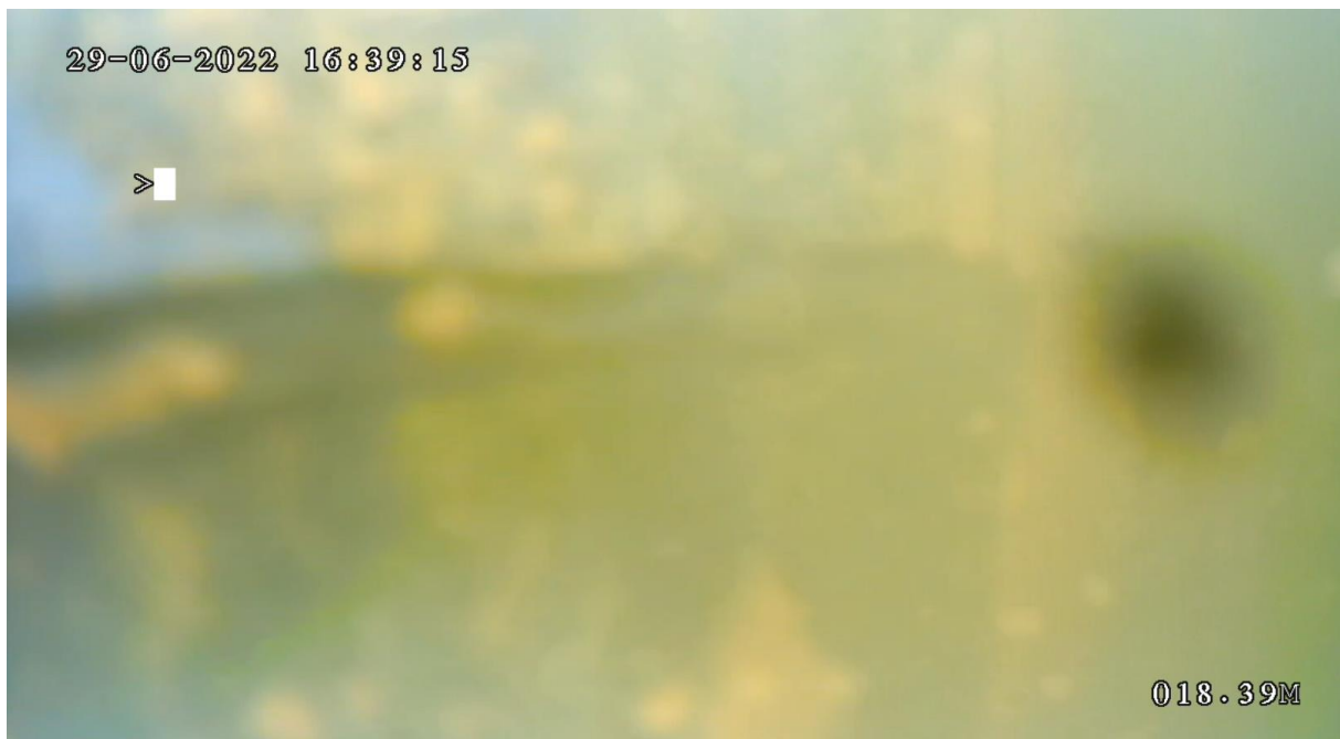
Photographie 7 : Joint horizontal visible à 18,39 m/repère
