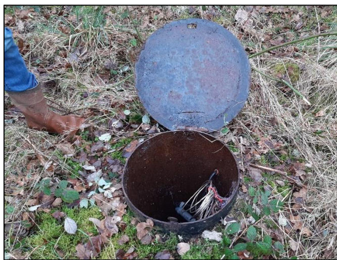
Figure 18 : Photographie de l'ouvrage réalisée lors de la visite de site du 25 janvier 2022
